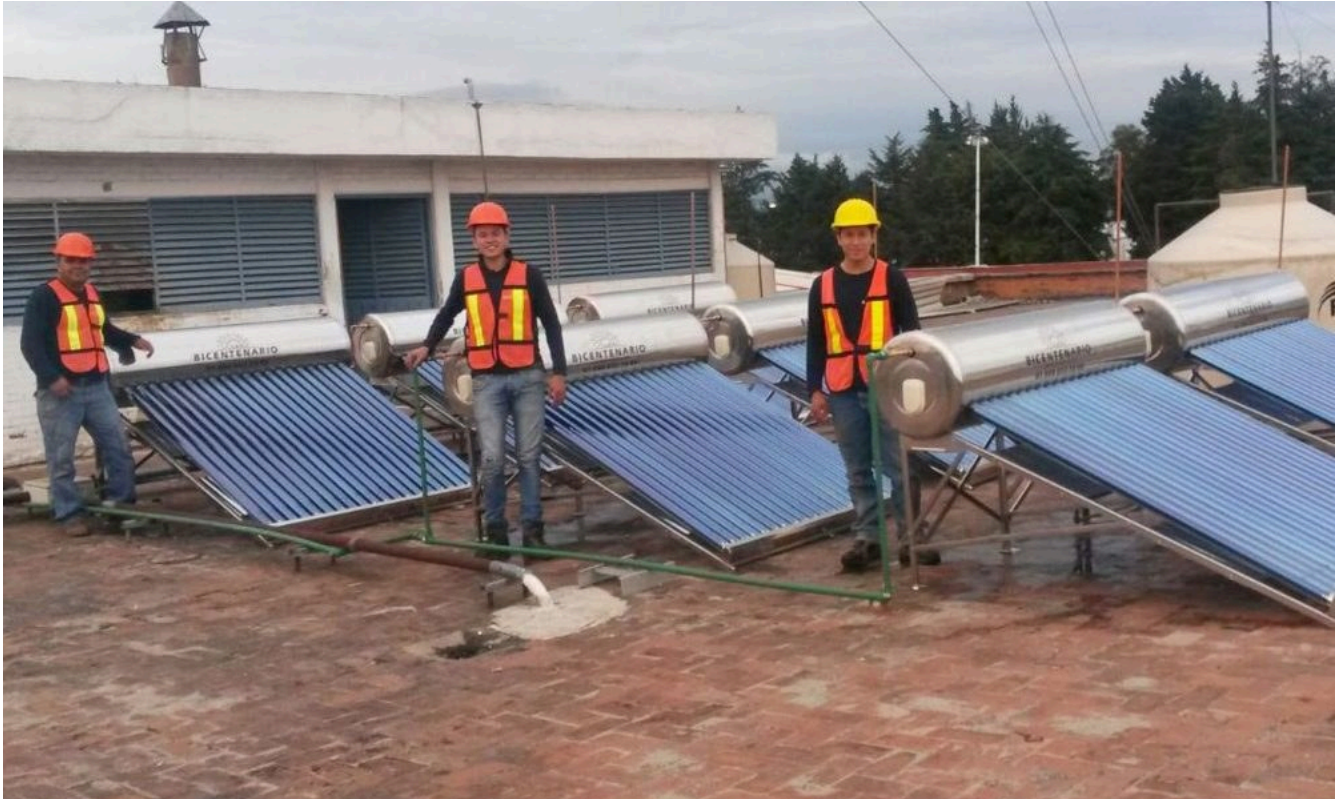
Batería de equipos Bicentenario en una instalación comercial.
